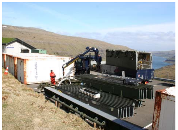
Radarudstyr, der skal skrottes på Færøerne.
