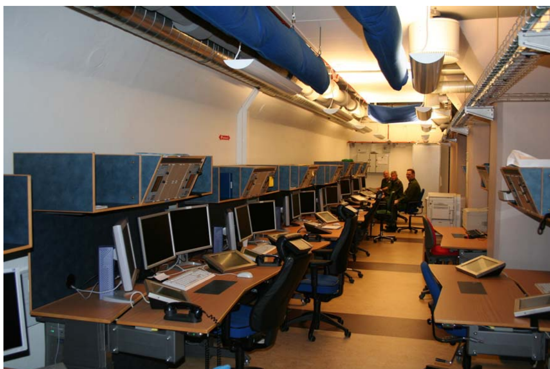
Operationsrummet i BK1100. (Foto: CRCKAR).
