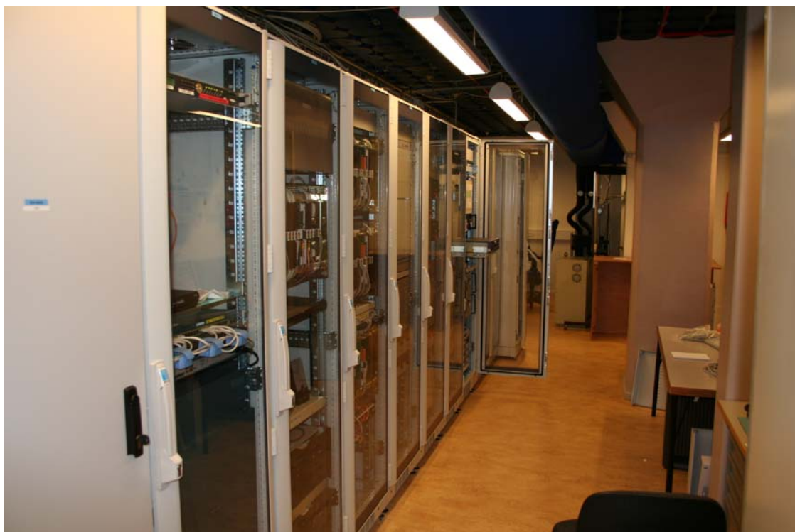
Kabinetter med teknisk udstyr i BK1100. (Foto: CRCKAR).
